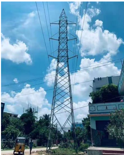
Слика 11. TS TRANSCO Hyderabad 132 kV (2019) [20]
