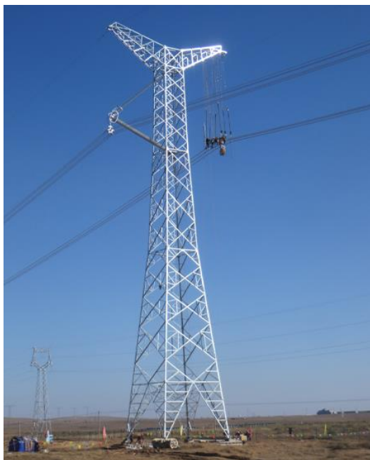
Слика 12. Linyhou-Shaoxing \pm 800 kV Overhead Transmission Line (2015) [20]
